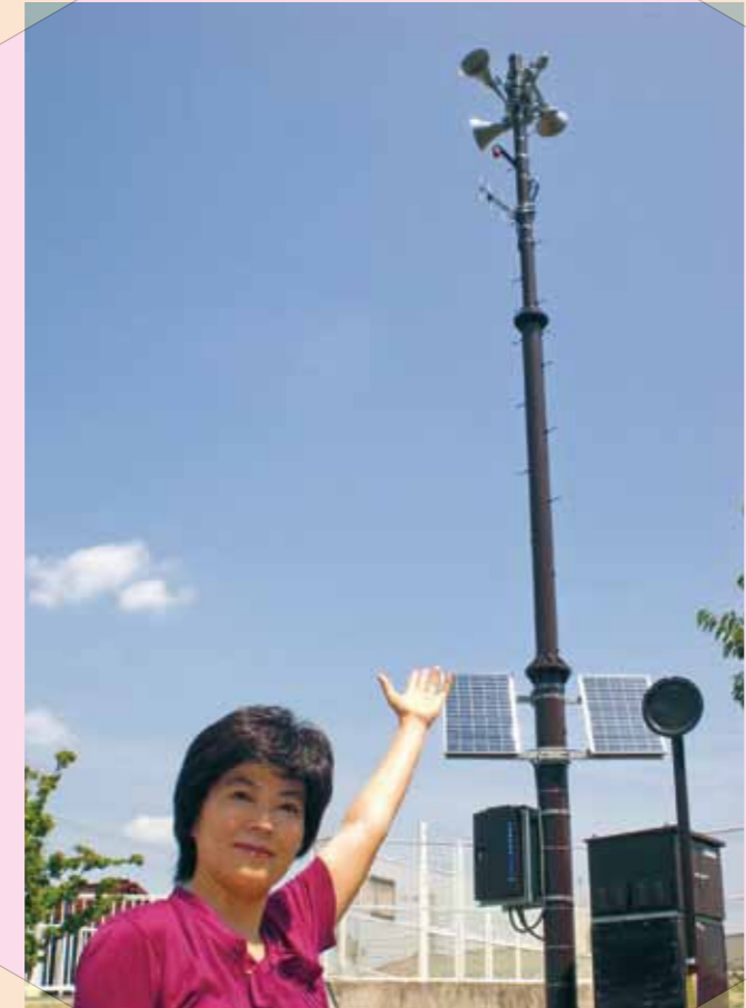
太陽光発電と蓄電池も装備(生麦貝ノ浜公園)
